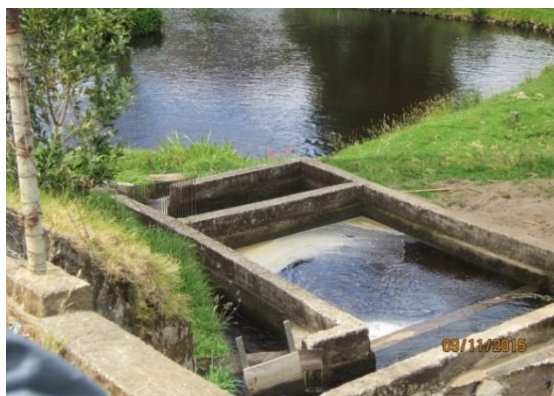
Figura 2 . Estructura del filtro de sedimentación. Autor: Socorro Sánchez F.
